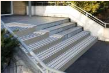
Przewody grzejne na schodach
